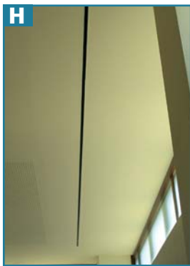
H. PARTICOLARE DI UN DIFFUSORE LINEARE DI MANDATA AD ALTA INDUZIONE INSERITO NEL CONTROSOFFITTO DI UNO DEI LOCALI. LA DIMENSIONE MOLTO RISTRETTA DELLA FERITOIA LO FA PASSARE PRESSOCHÈ INOSSERVATO.
