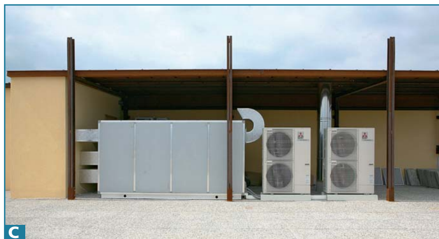
C. LA CENTRALE TERMOFRIGORIFERA SULLA COPERTURA DELL'EDIFICIO. E' VISIBILE L'UNITÀ DI TRATTAMENTO D'ARIA CHE INCORPORA ANCHE LO SCAMBIATORE DI CALORE REFRIGERANTE-ACQUA, LA POMPA E IL VASO DI ESPANSIONE PER L'ALIMENTAZIONE DEI PANNELLI RADIANTI NEL PAVIMENTO, OLTRE ALLA BATTERIA A ESPANSIONE DIRETTA, IL VENTILATORE, IL RECUPERATORE DI CALORE TOTALE ARIA-ARIA LOSSNAY E I FILTRI PER IL CIRCUITO AEREAULICO. A LATO SONO INSTALLATE LE DUE SEZIONI ESTERNE VRF DELLE QUALI UNA È COLLEGATA ALLO SCAMBIATORE DI CALORE FRIGORIGENO-ACQUA, L'ALTRA ALLA BATTERIA AD ESPANSIONE DIRETTA NELLA MACCHINA. IN PRATICA, L'INTERA CENTRALE TERMOFRIGORIFERA È CONTENUTA IN QUESTE TRE MACCHINE.
